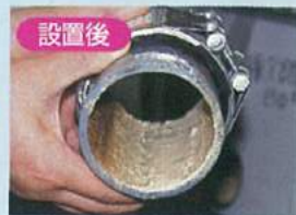
設置後 1年後、尿石の蓄積はほぼ改善された
