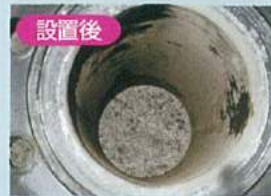
設置後 約3ヶ月後、管壁に付着していたスケールが、剥がれているのを確認
