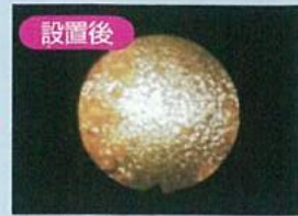
設置後 管壁が確認できるほど、赤サビ部分が減少
